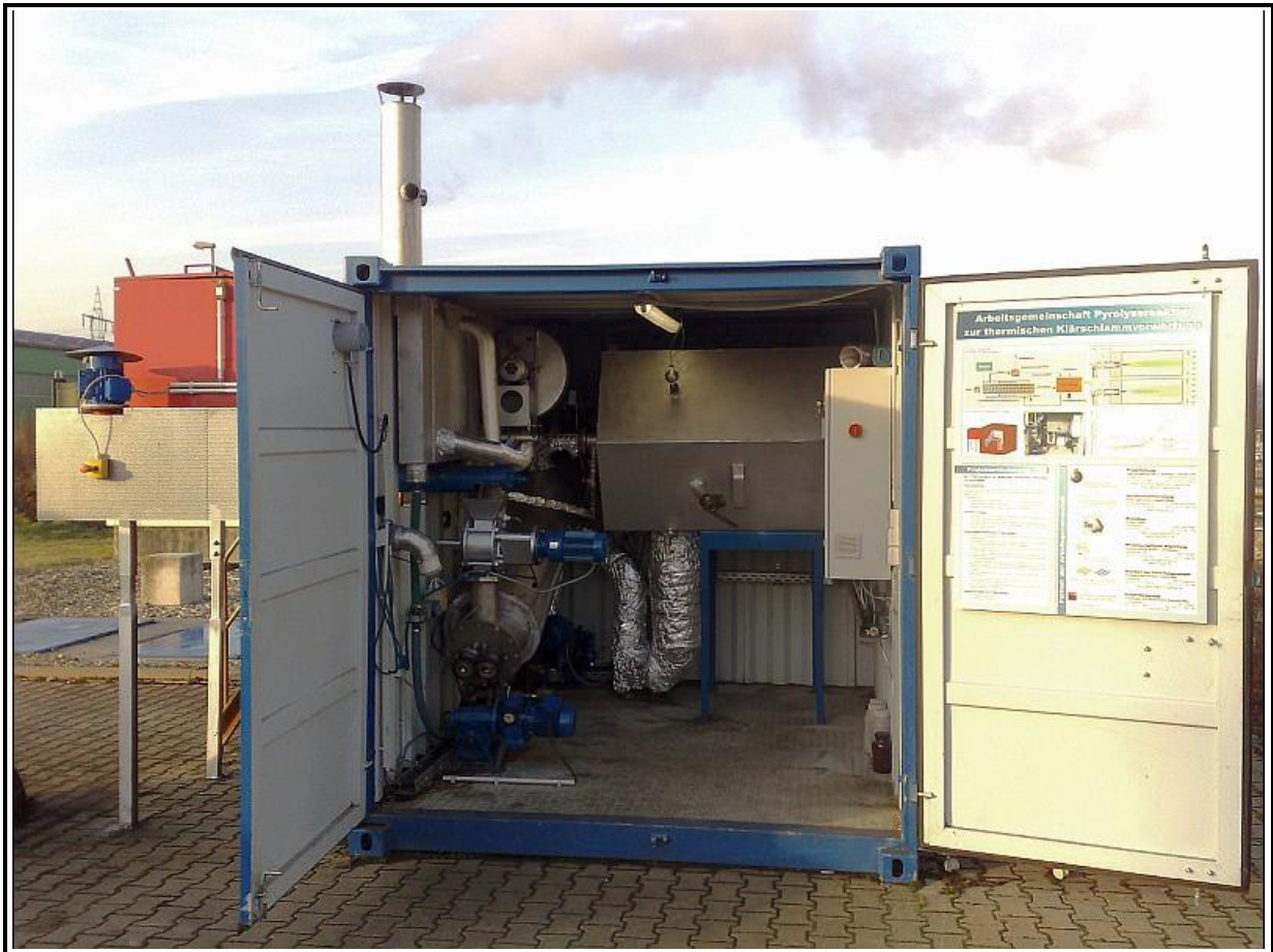
Abb. 3: Pilotanlage auf der Kläranlage "Untere Selz" in Ingelheim
